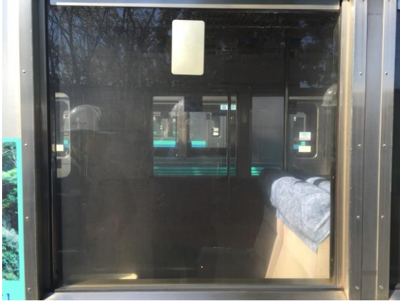
2か所の窓を対象に作業開始 両面とも汚れがひどく曇ったような状態、海が見えないなどの状態
