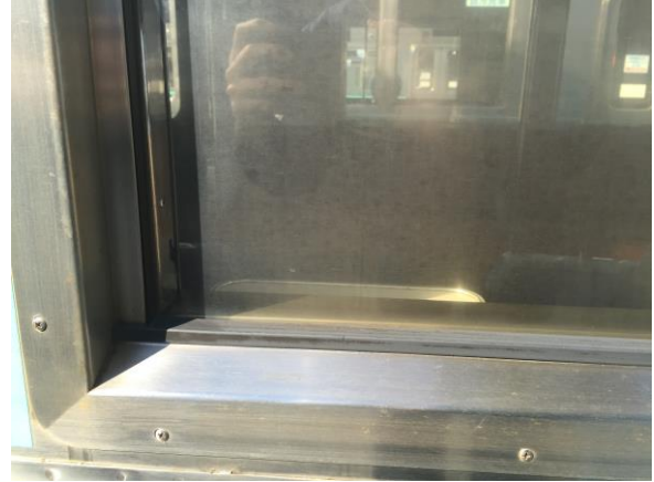
施工前のガラスの状態。 ガラスはほとんど中が見えない状態である。窓ワクにも汚れが残っている。
